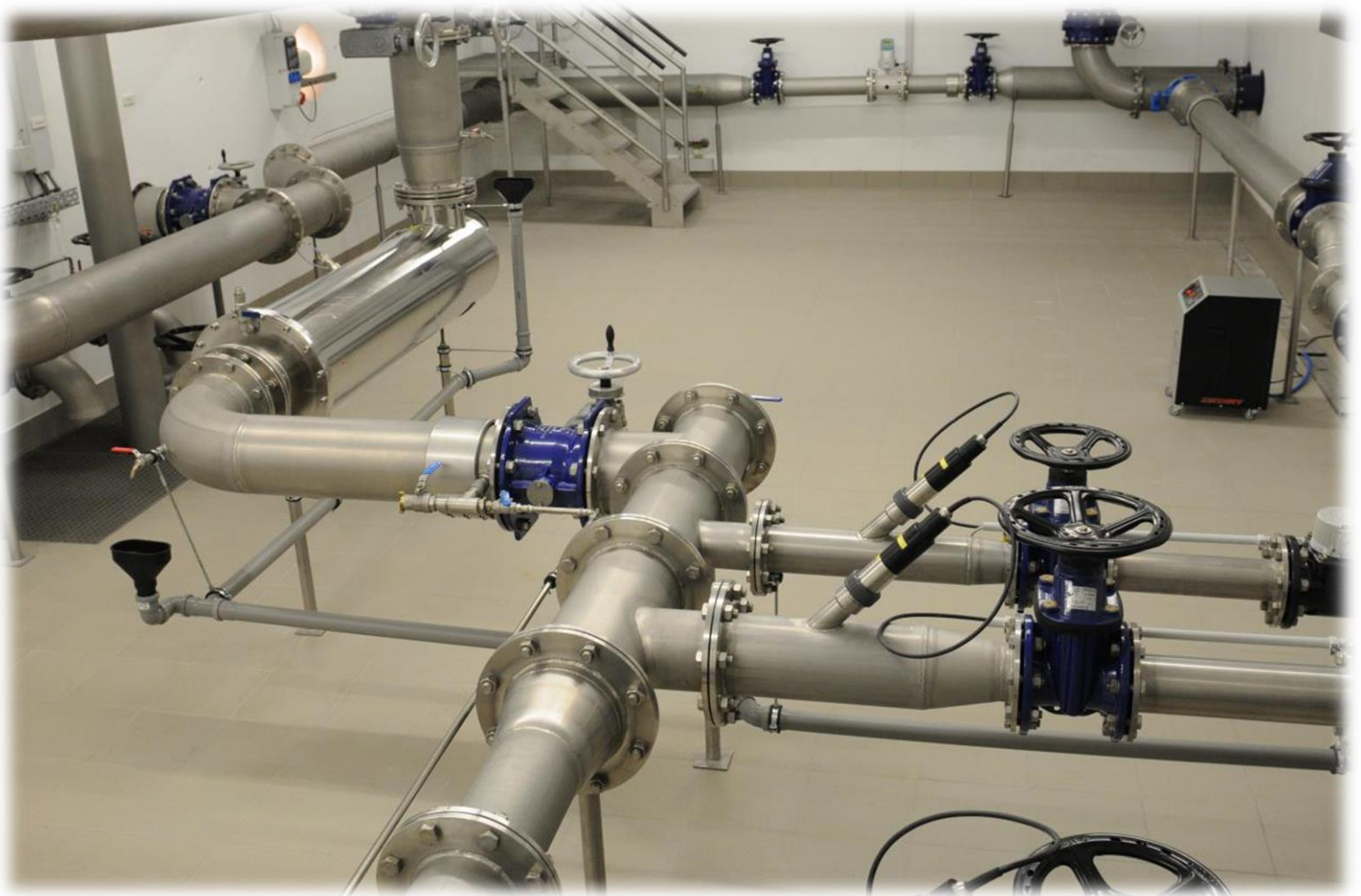
Schieberkeller im Hochbehälter Oberbeuren
